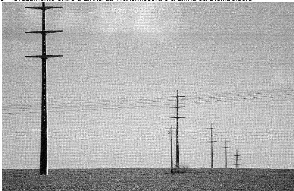
Figura 3 – Cruzamento entre a Linha da Transmissora e a Linha da Distribuidora
